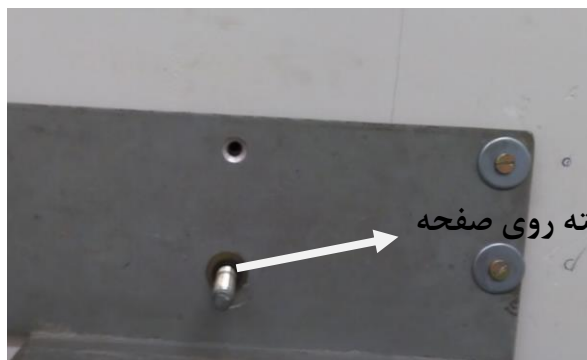
شکل ۶- صفحه مخصوص کنترل صفر شاخص نصب شده روی دیوار
